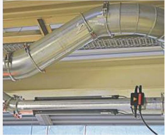
Rohrionisation TI-150-4 installiert in einer Förderstrecke zur Entladung von Granulat.
